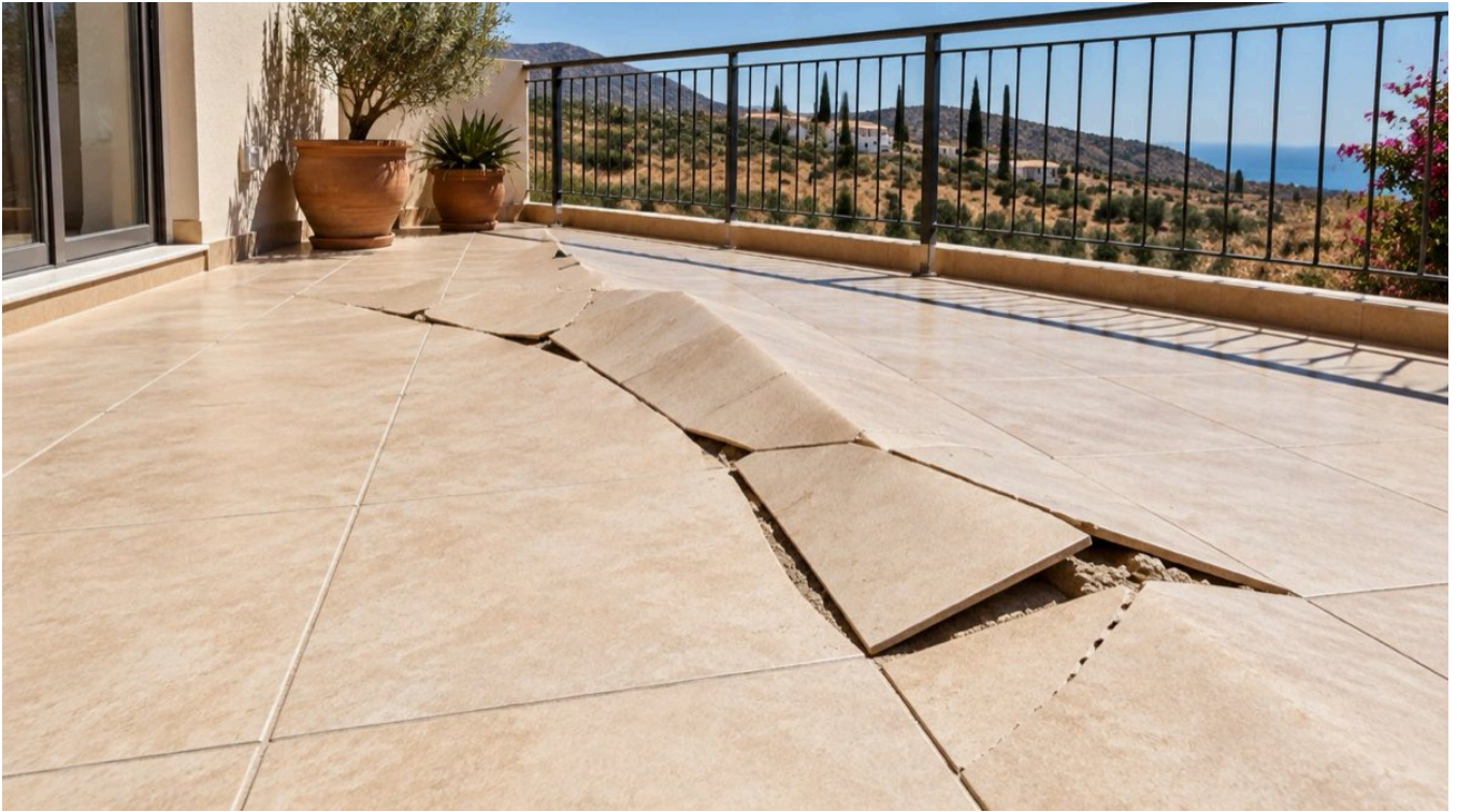
aufgewölbte Terrassenfliesen ohne Dehnungsfuge.
