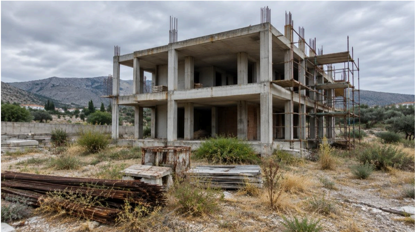
stillgelegte Baustelle. Das Bauträgerrisiko in einem Bild.
