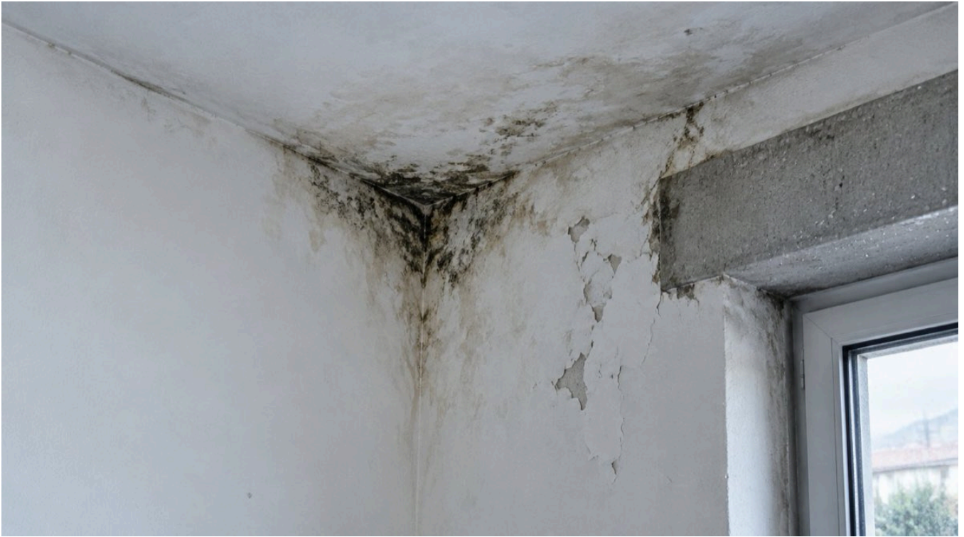
Schimmel in der Zimmerecke nach dem Winter.
